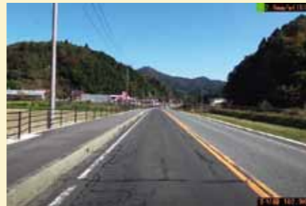
ひび割れ率が高い路面
