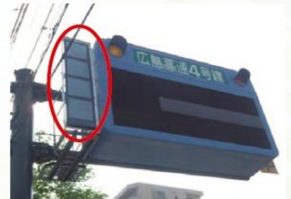
常設情報板の故障対応としての設置例
